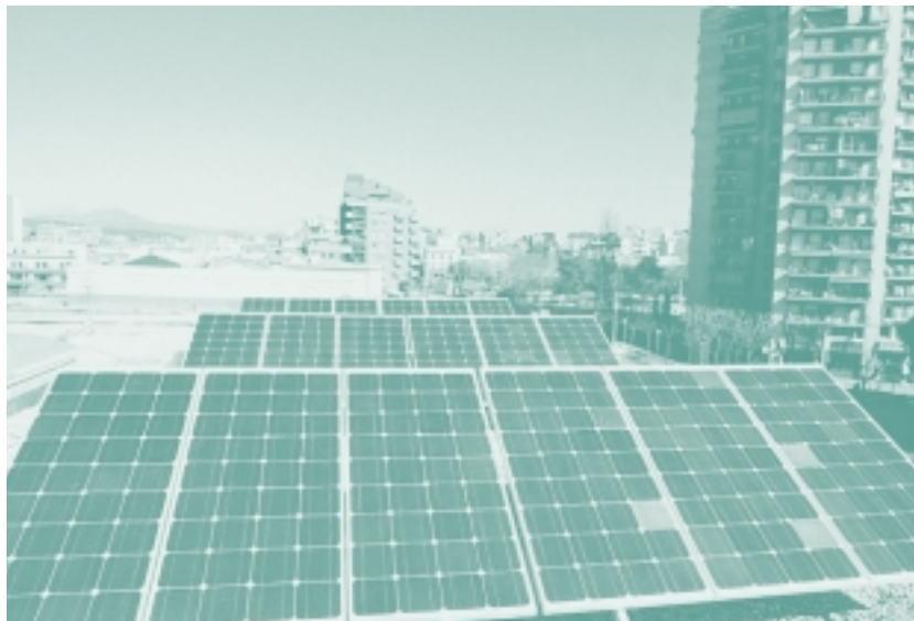
Instal·lació fotovoltaica a la coberta de l'edifici Rubí Desenvolupament
